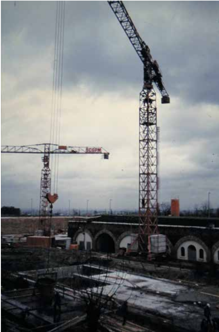
La construction de la nouvelle zone technique au fort de Rosny en 1984.
